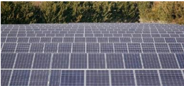
Figura 4 Particolare pannelli fotovoltaici
